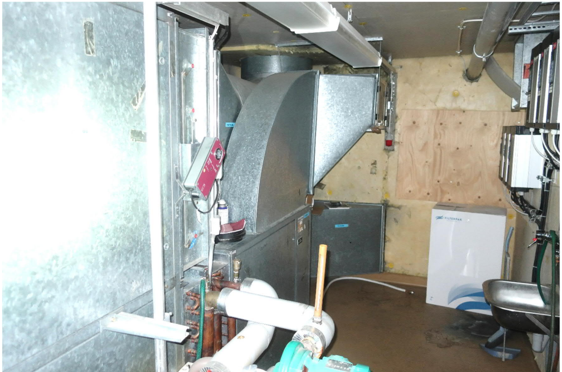
Kuva 78. Yleiskuva osan 3 2. kerroksen tilojen ilmanvaihtokonehuoneesta, joka sijaitsee yläpohjatilassa/vesikatolla varastotilan 348 yläpuolella. Ilmanvaihtokoneet ovat vuodelta 1988.
