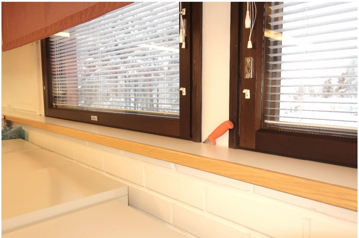
Kuva 57. Ikkunoiden karmiliittymien ilmatiiveys on kaikkein heikoimmalla tasolla osan 3 2. kerroksen tiloissa, missä ikkunaliittymissä on systemaattisesti toistuvat, silmännähtävät raot. Kuvaossa ikkunalaudan takana olevaan rakoön on työnnetty puukko.
