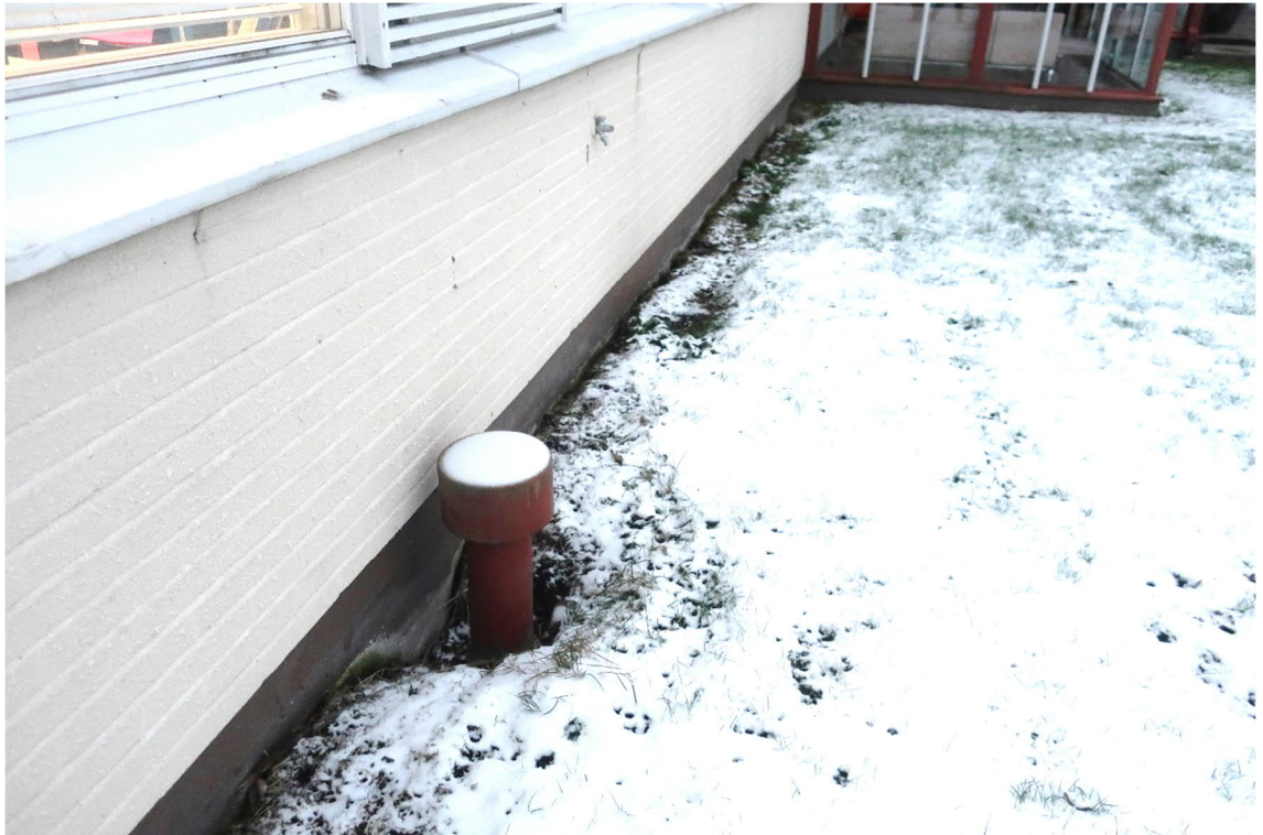
Kuva 15. Paikallisia lammikoitumiskohtia havaittiin osan 1 pohjoisjulkisivulla erityisesti huoltotunnelin korvausilmaputkien kohdilla, missä maa on painunut
