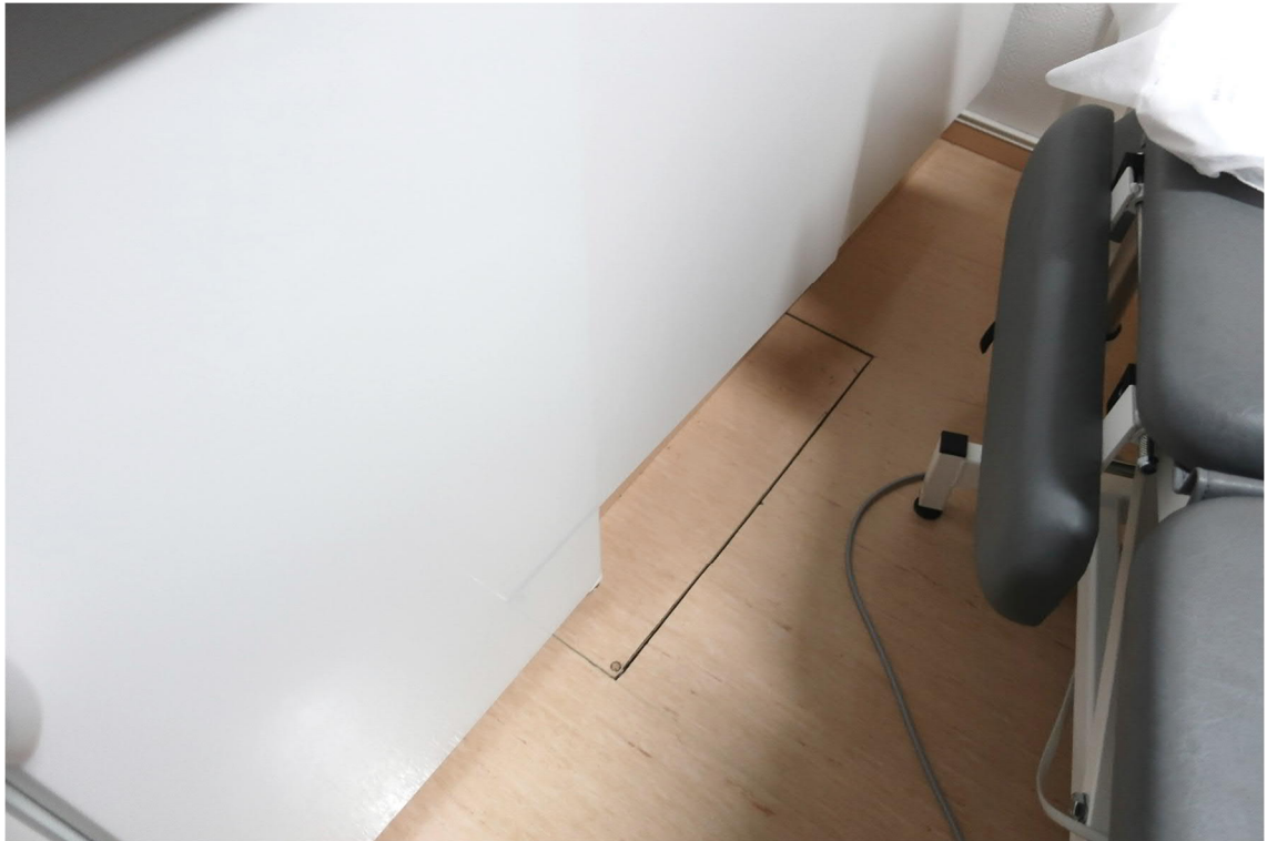
Kuva 41. Osan 3 2. kerroksen huonetilojen levyrakenteisissa lattioissa on tarkastusluukkuja, jotka eivät ole ilmatiiviitä. Lattian koolaustilan ollessa alipaineistettu ilmavirtauksen suunta on kuitenkin sisätiloista lattiarakenteeseen päin, mikä on sisäilman laadun kannalta hyvä asia. Kuva on otettu tilasta 341b.
