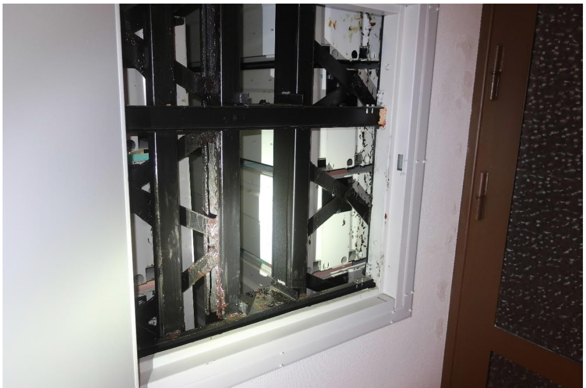
Kuva 81. Osan 3 arkistohissin hissikuilussa esiintyy tunnistettavaa konerasvan, metallin ja pölyn hajua, jota voi kulkeutua myös sisäilmaan erityisesti arkistohissin liikkeessä. Lisäksi arkistohissin kautta on ilmayhteys sen huoltotunnelissa sijaitsevaan konehuoneeseen, jonka kautta voi periaatteessa tapahtua ilmavuotoa myös maaperästä sisäilmaan.
