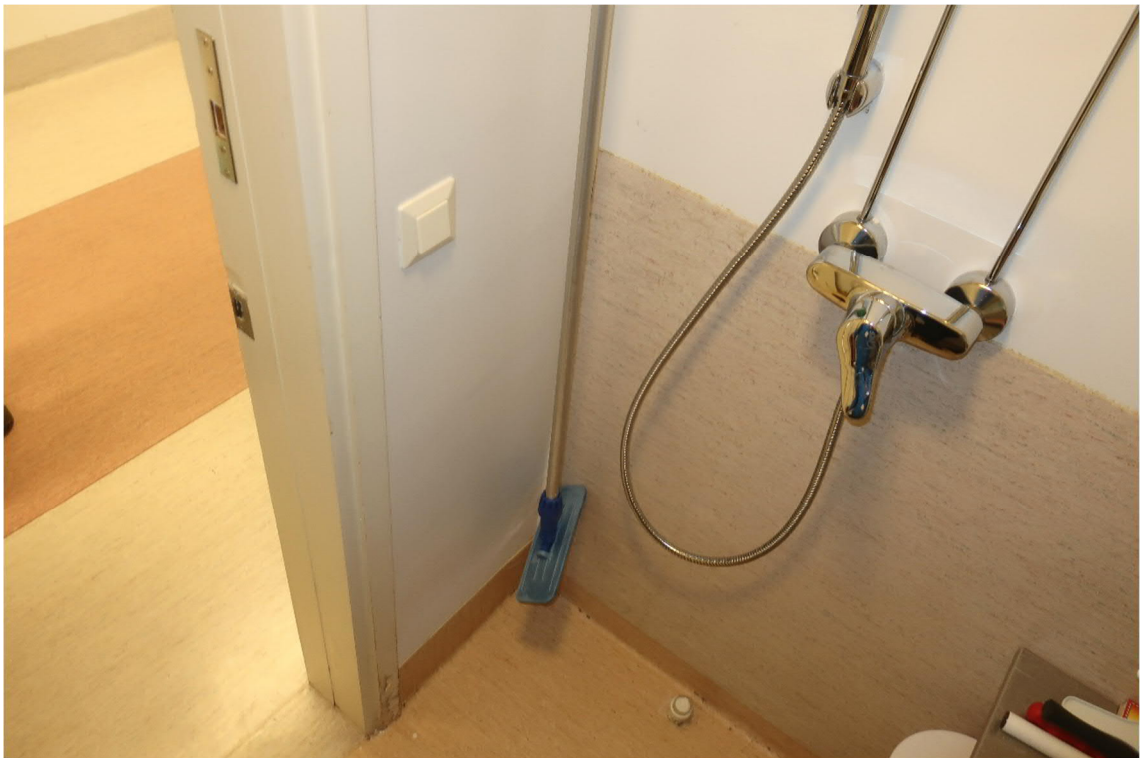
Kuva 73. Siivouskomeron 210 tavanomaista kosteamman väliseinän vieressä oleva vesihana on mallia, jota normaalisti käytetään ainoastaan suihkutiloissa. Tilassa ei ole lainkaan pesuallasta, ja hanasta/suihkusta valuva vesi on kastellut väliseiniä.
