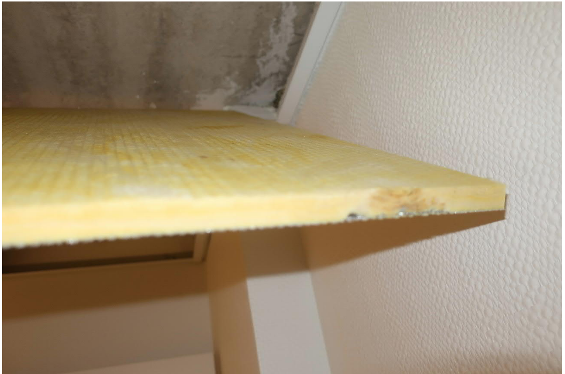
Kuva 79. Ainakin osan 3 2. kerroksen tilojen alkuperäisten alakattolevyjen sivuilla ja taustoilla on pinnoittamatonta mineraalivillaa, josta voi irrota sisäilman laatua heikentäviä teollisia mineraalikuituja.
