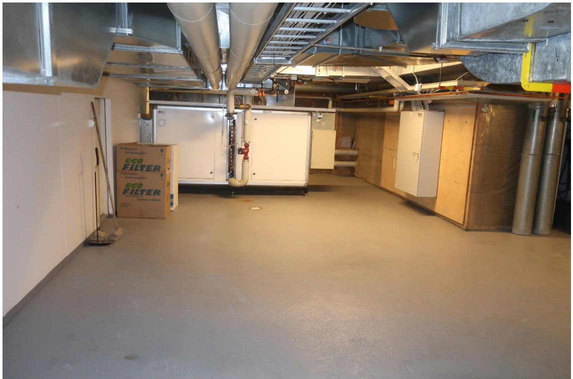
Kuva 76. Yleiskuva kellarikerroksen ilmanvaihtokonehuoneesta 040.
