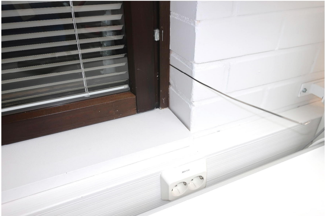
Kuva 56. Ikkunaliittymissä on paikoin ilmavuotoreitteinä toimivia rakoja. Kuva on otettu osan 3 2. kerroksesta.
