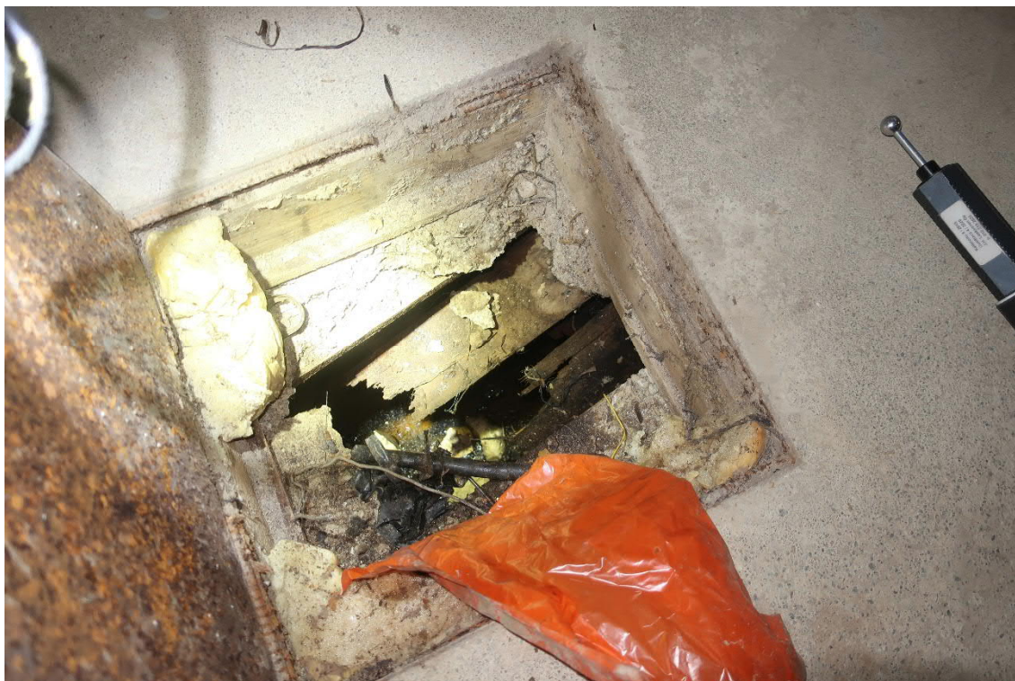
Kuva 18. Rakennuksen luoteisnurkan läheisyydessä (arkistohissin huoltoluukkujen lähellä) osan 3 huoltotunnelin lattiassa olevan yksittäisen salaojien tarkastuskaivon kautta 5.1.2021 tehtyjen havaintojen mukaan vedenpinta kaivossa oli noin 0,5 m huoltotunnelin lattiapinnan alapuolella (noin 0,1 m kellarikerroksen tilojen lattiapinnan alapuolella). Kaivossa ollut vesi oli kirkasta, ja veden virtausta ei ollut havaittavissa. Kaivossa oli lisäksi lahonnutta puumateriaalia.
