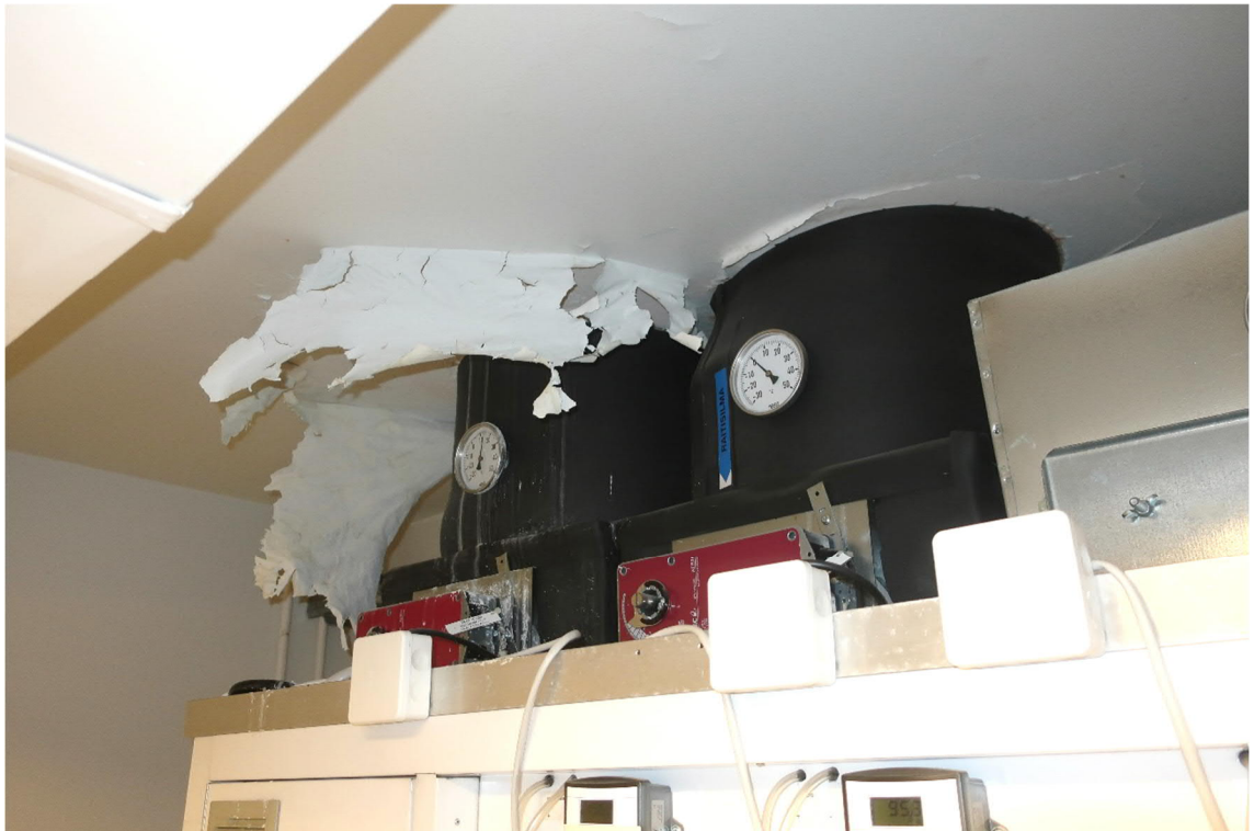
Kuva 39. Osan 2 kellarikerroksen kattopinnalla havaittiin yksittäinen vesivuotojälki tilassa 027. Vettä on valunut katossa olevan ilmanvaihtokanavan läpiviennin kautta irrottaen katon tasoite-/maalipintaa läpiviennin ympäriltä. Vuodon aiheuttajasta ei ole tietoa. Tutkimushetkellä pinta-kosteusilmmaisimen (GANN) lukemat katon betonipinnalla olivat 80...90, minkä perusteella välipohjarakenne oli ko. kohdalla hieman tavanomaista kosteampi.
