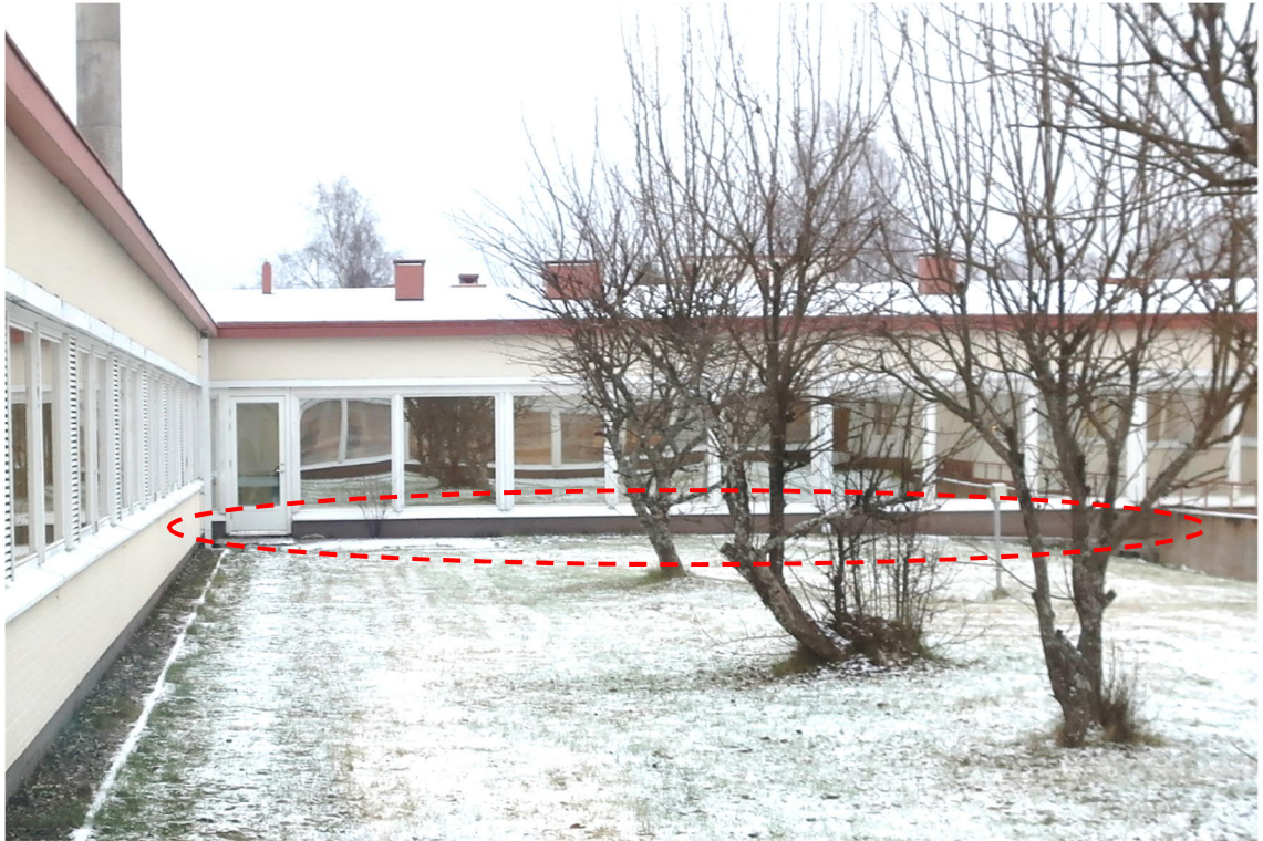
Kuva 43. Pienemmillä alueilla lähinnä 1. kerroksen käytävien sisäpihan puoleisten ikkunaseinien alaosissa ulkoseinissä on korkeampi valesokkelirakenne. Sokkelin yläpinta on ko. seinien kohdilla noin 15 cm lattiapinnan yläpuolella. Kuvassa näkyy osan 1 sisäpihan vastainen ulkoseinä.
