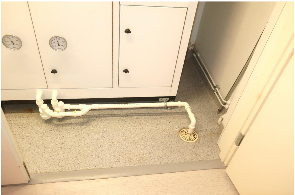
Kuva 83. Ajoittain rakennuksessa esiintyy myös viemärinhajua, joka aiheutuu lähinnä ilmanvaihtokonehuoneiden ja vailla käyttöä olevien lukuisten wc-tilojen kuivuvista lattiakaivoista. Kuva on otettu tilasta 190.
