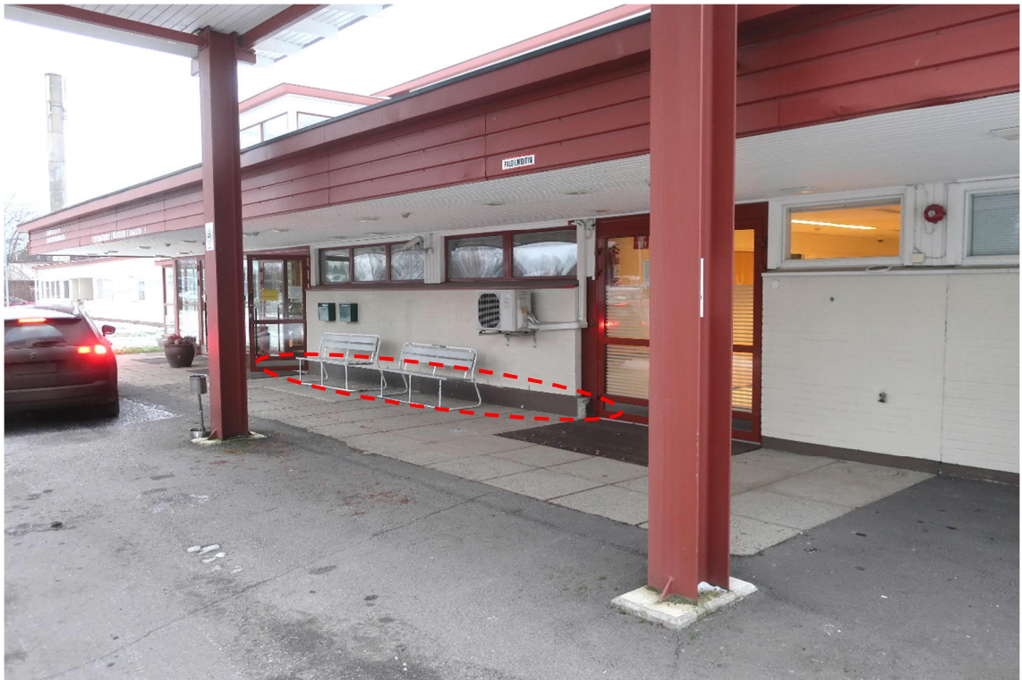
Kuva 45. Myös osan 3 pohjoispäädyn sisäänkäynnin läheisyydessä on paikallisesti korkeampaa valesokkelirakennetta.
