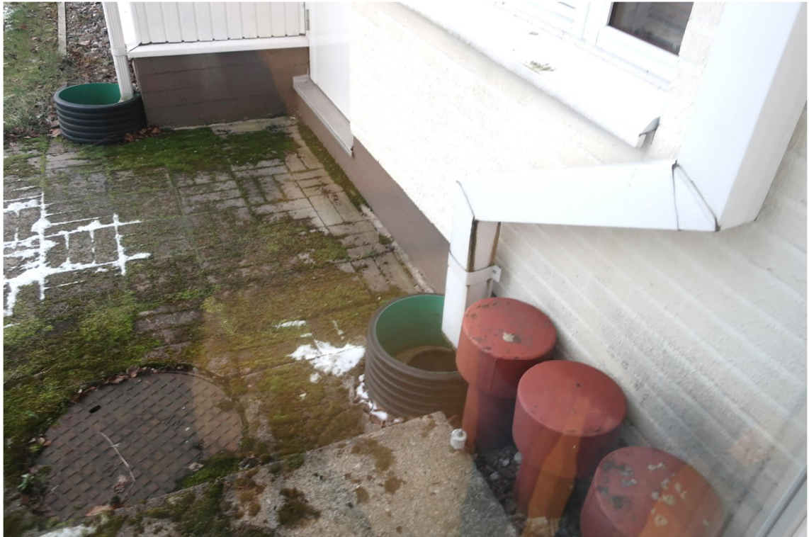
Kuva 17. Syöksytorstista purkautuvat kattovedet on ohjattu suurimmaksi osaksi suoraan rännikaivoihin. Kuva on otettu sisäpihalta osien 2 ja 3 välisestä nurkasta, missä kattovedet olivat aiemmin vuoden 2007 jälkeen valuneet rännikaivon ohi kastellen maanvastaista seinärakennetta. Tutkimushetkellä 30.11.2020 em. ongelma oli jo korjattu.
