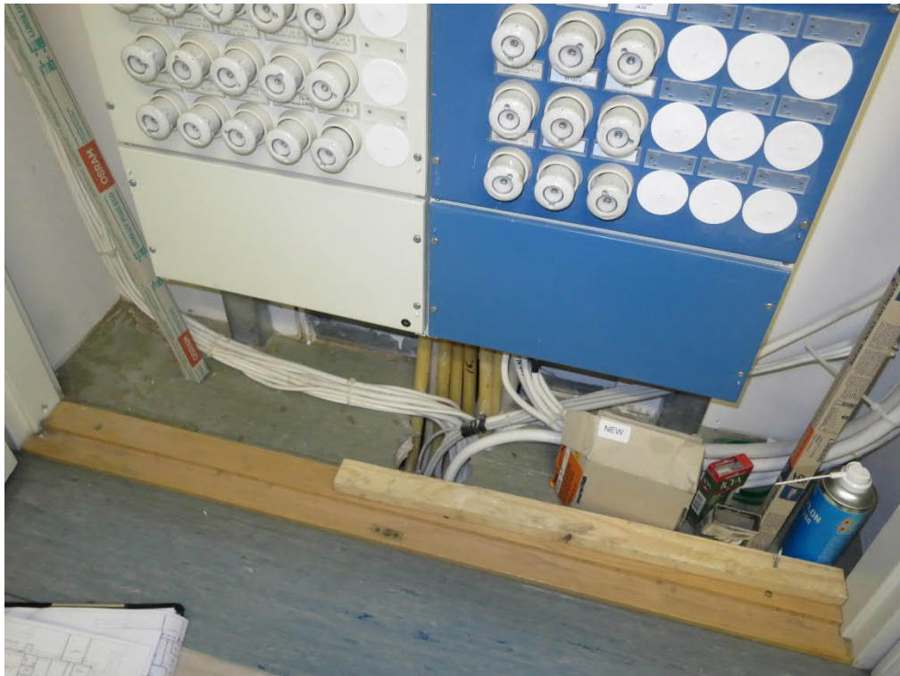
Kuva 40. Eri kerrosten välillä olevat talotekniikan läpiviennit eivät ole ilmatiiviä. Läpivientien tiiviyyttä ei tarkastettu systemaattisesti koko rakennuksen alueella, mutta puutteita oli havaittavissa esimerkiksi sähkökeskusten kohdilla olevien läpivientien tiiveydessä. Kuva on otettu osan 3 2. kerroksesta, missä välipohjan sähköläpivienti on tiivistämättä.
