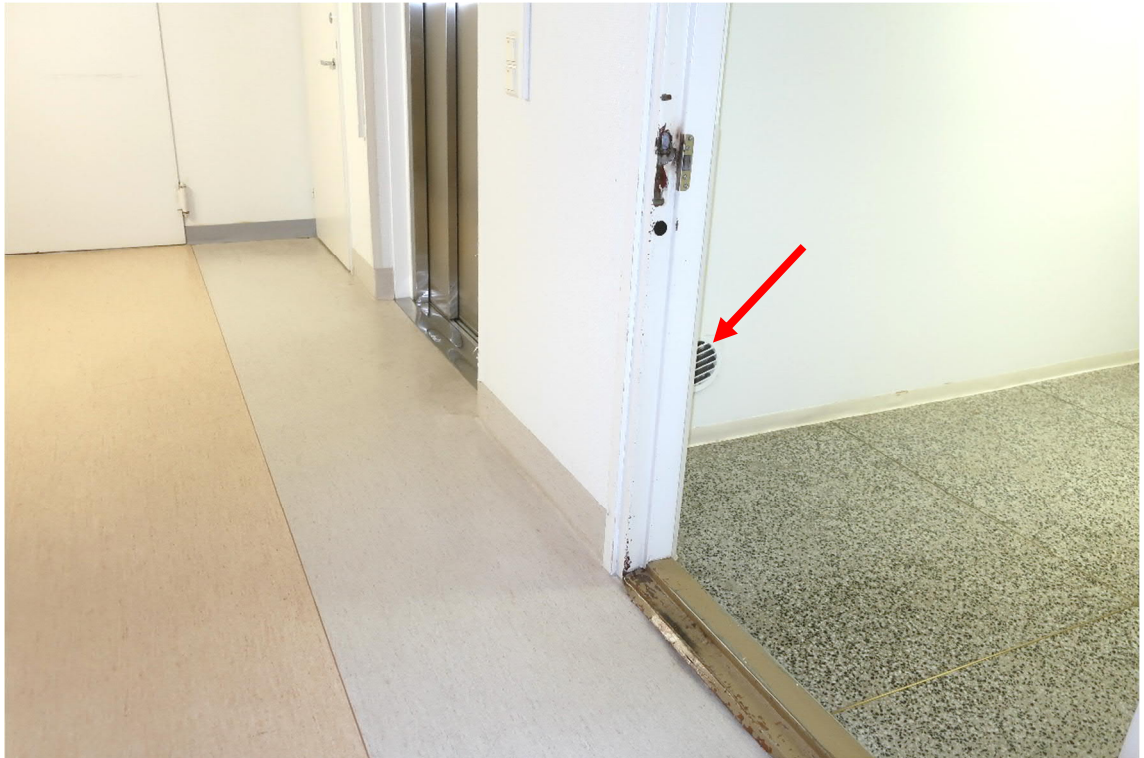
Kuva 82. Porrashuoneeseen 020 puolestaan virtaa seinässä olevan siirtoilmäsäleikön kautta tunkkaista ilmaa viereisestä hissikuilusta 024 erityisesti hissien liikkuesssa.
