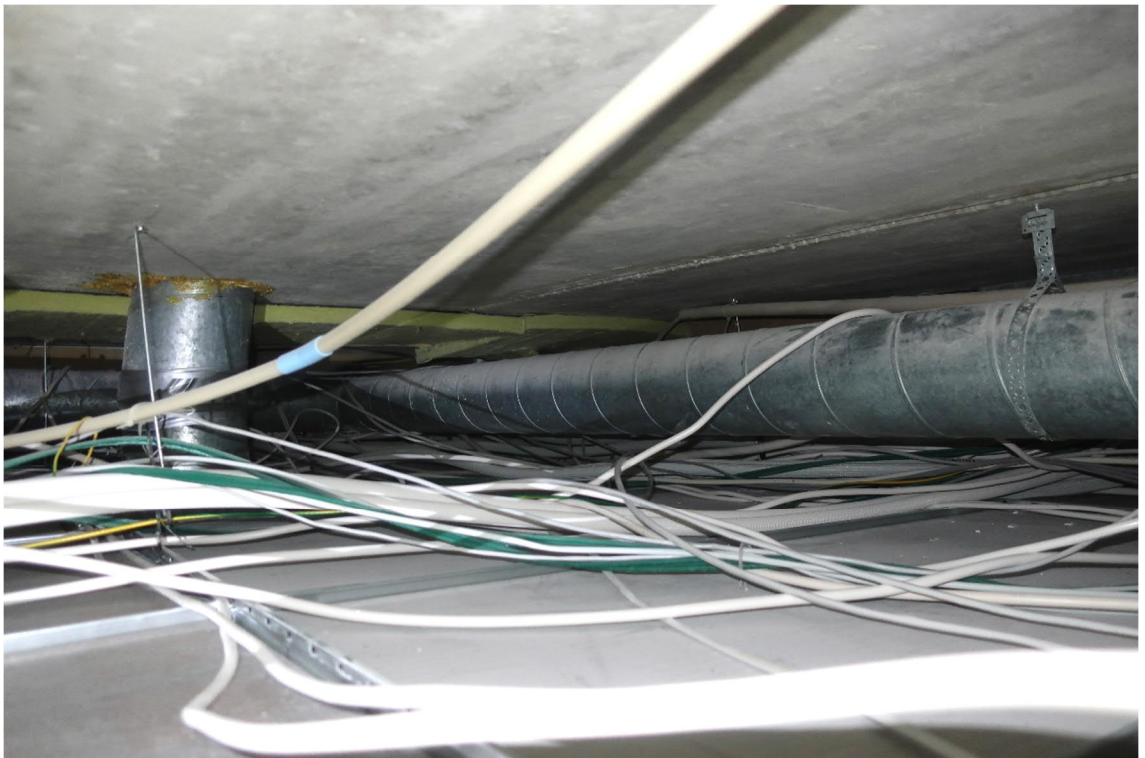
Kuva 80. Yleiskuva osan 3 2. kerroksen alakattotilasta. Alakattotiloissa on paikoin rakennuspölyä ja pinnoittamattomia mineraalivillapintoja.
