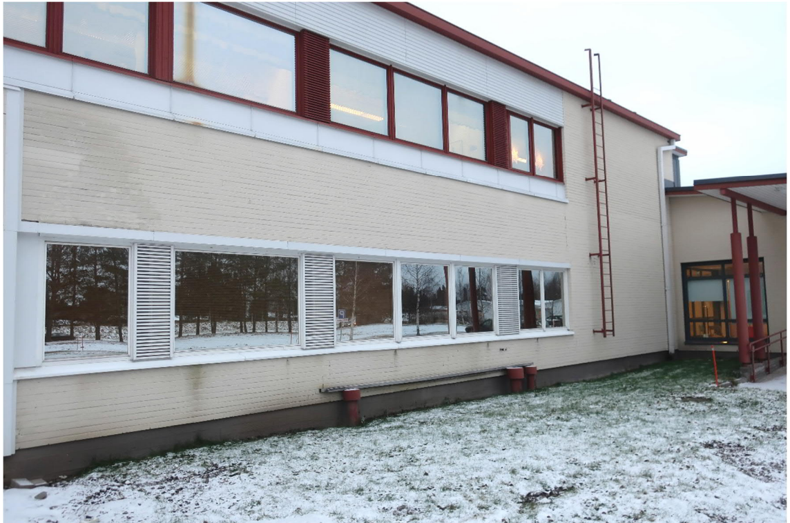
Kuva 55. Myös puu-, pelti- ja levyverhotut julkisivujen osat ovat hyvässä tai tyydyttävässä kunnossa. Kuva on otettu osan 3 länsijulkisivulta.
