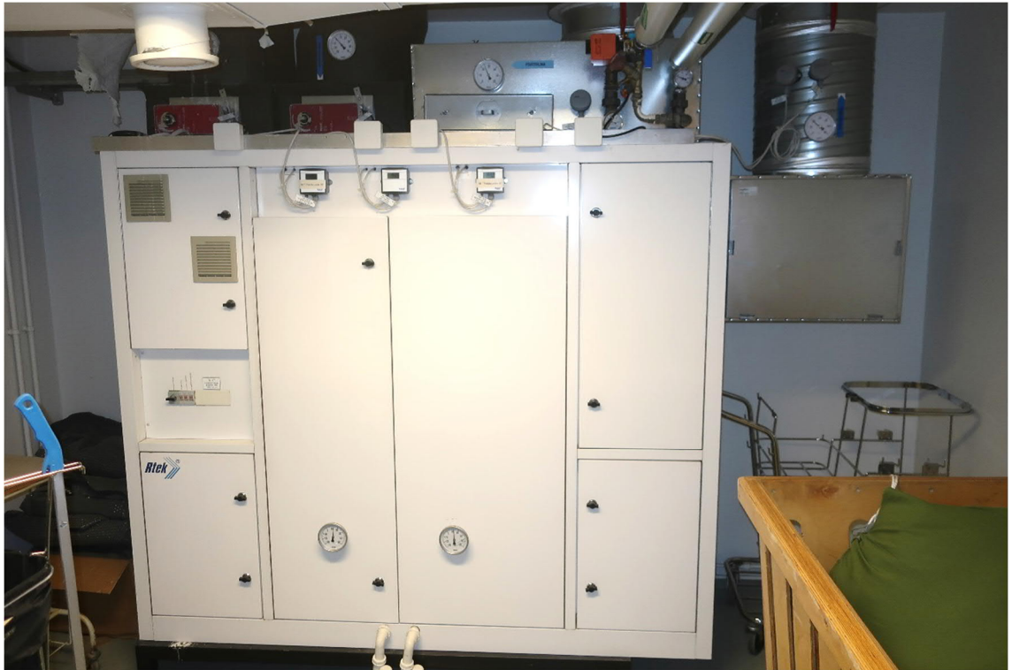
Kuva 77. Yleiskuva kellarikerroksen tilassa 027 sijaitsevasta ilmanvaihkokoneesta.
