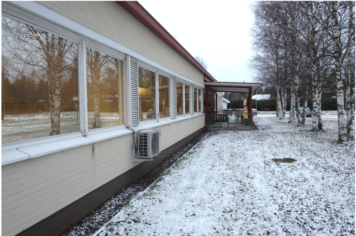
Kuva 54. Julkisivupinnat ovat silmämääräisesti arvioituna yleisesti vielä hyvässä kunnossa. Paikoin ikkunoiden vesipeltien päältä valuneet sadevedet ovat lianneet julkisivupintoja vesipellitösten kiinnityslankojen kohdilla. Sokkeleiden maalatut betonipinnat ovat yleisesti hyväkuntoisia. Kuva on otettu osan 2 eteläjulkisivulta.
