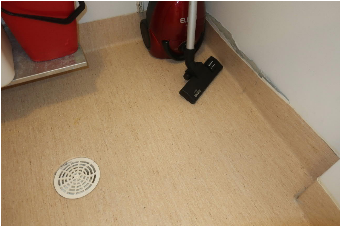
Kuva 72. Siivouskomerossa 210 lattiapinnalta ja yksittäisen kiviaineisen väliseinän pinnalta mitattiin selvästi tavanomaista korkeampia pintakosteuslukemia väliltä 90...100, väliseinien maali- ja tasoitekerroksissa oli näkyviä kosteusrasituksen aiheuttamia vaurioita, ja muovimaton seinäylösnosto oli irronnut alustastaan kosteusrasituksen seurauksena. Ks. myös seuraava kuva.
