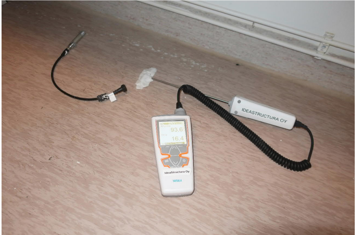
Kuva 27. Viiltokosteusmittaus pisteessä K1 osan 2 kellarikerroksen käytävällä 006. Suhteellinen kosteus muovimaton alla oli 94 % RH.
