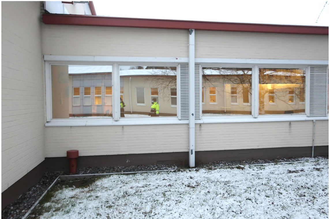
Kuva 62. Räystäskouruihin ja syöksytorviin liittyen ei ole tiedossa erityisiä ongelmia tai vikoja. Kattovesijärjestelmien laskennallinen tekninen käyttöikä on niiden materiaalista riippuen noin 25...40 vuotta. Jos nykyiset kattovesijärjestelmät ovat vuodelta 1988, ne alkavat jo olla käyttöikänsä loppupuolella. Kuva on otettu osan 2 eteläjulkisivulta.
