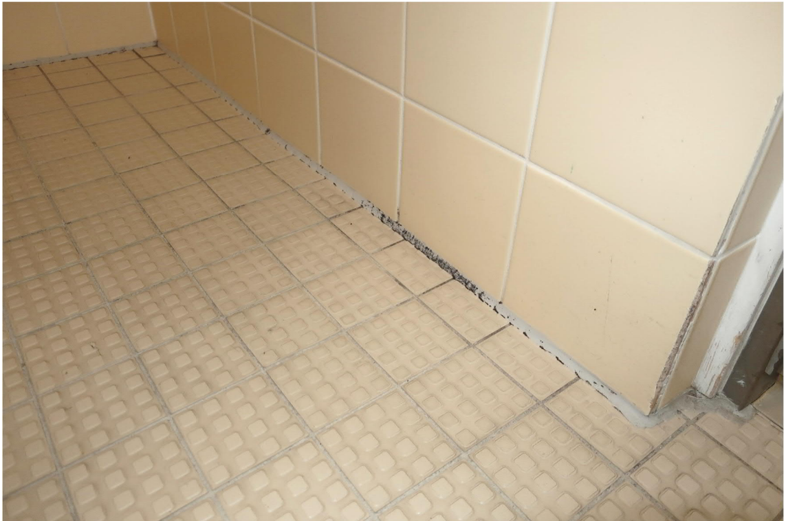
Kuva 75. Ainakin osan 1 kylpyhuoneiden lattianurkkien silikonisaumauksisten pinnoilla esiintyy paikoin mikrobikasvustoa. Märkätilojen silikonisaumauksissa olevat homepilkut ovat usein viite tilojen puutteellisesta ilmanvaihdosta ja liian hitaasta kuivumisesta suihkussa käymisen jälkeen.
