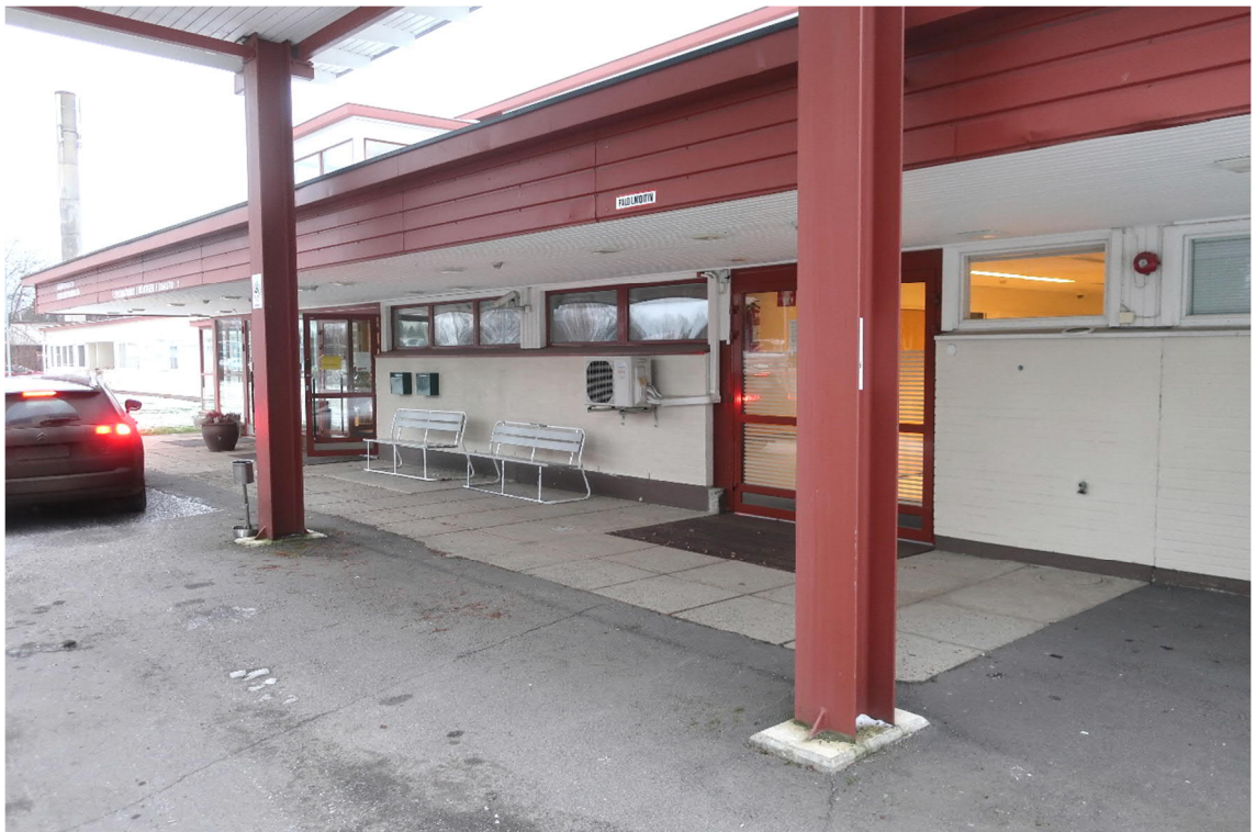
Kuva 13. Pohjoissivun sisäänkäynnin läheisyydessä maanpinta on hyvin lähellä lattiapinnan korkeusasemaa.
