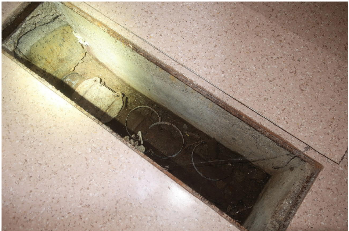
Kuva 29. Käytävän 006 lattiassa on yksittäinen pohjaviemärin tarkastusluukku, joka ei ole ilmatiivis. Tutkimushetkellä luukun kohdalla oleva betonirakenteinen syvennys oli kostea ja tarkastusluukun alapinnan vaneri oli märkä.
