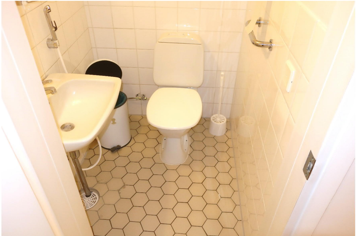
Kuva 70. Osan 3 2. kerroksen märkätilojen pintarakenteet ovat alkuperäiset, vuodelta 1988. Wc-tilojen lattia- ja seinäpinnoilla on keraaminen laatoitus.
